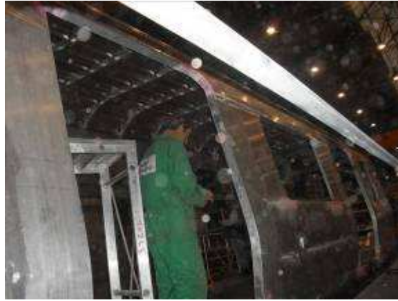
Trabajador de la subcontrata de Faustino Hermanos sin protección ocular junto a un trabajador esmerilando.
