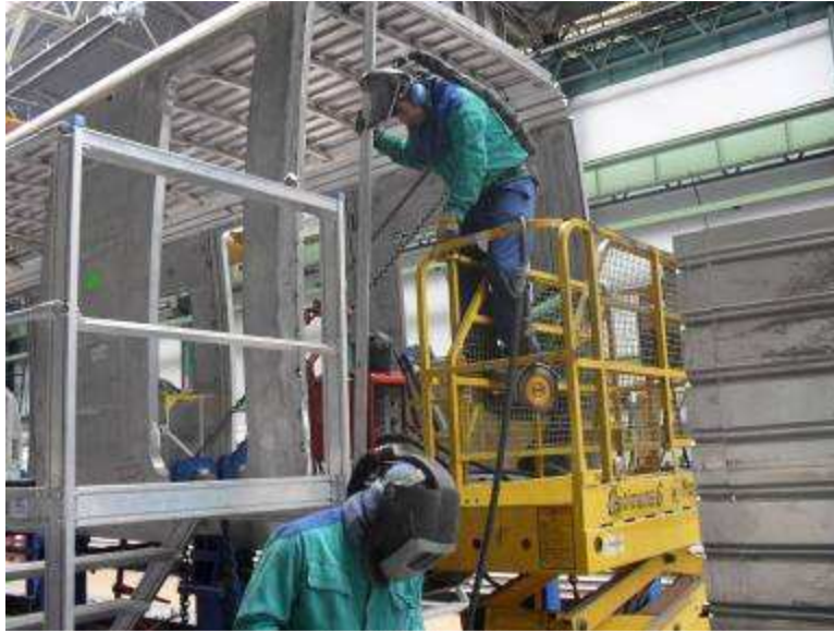
6.nabean langileak erortzeko arriskuan Trabajando hacinados y con riesgo de caída a distinto nivel en nave 6.
