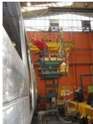
Trabajadoras de la subcontrata de la limpieza trabajando con riesgo de caída a distinto nivel.
